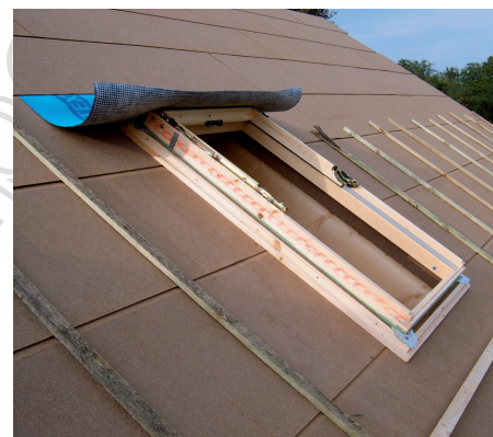
Photo: cuvette au dessus de la fenêtre.
